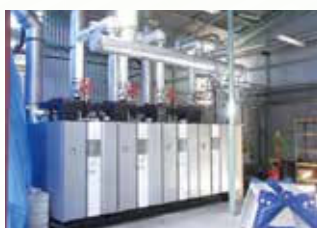
同心染工(株)さまボイラー
